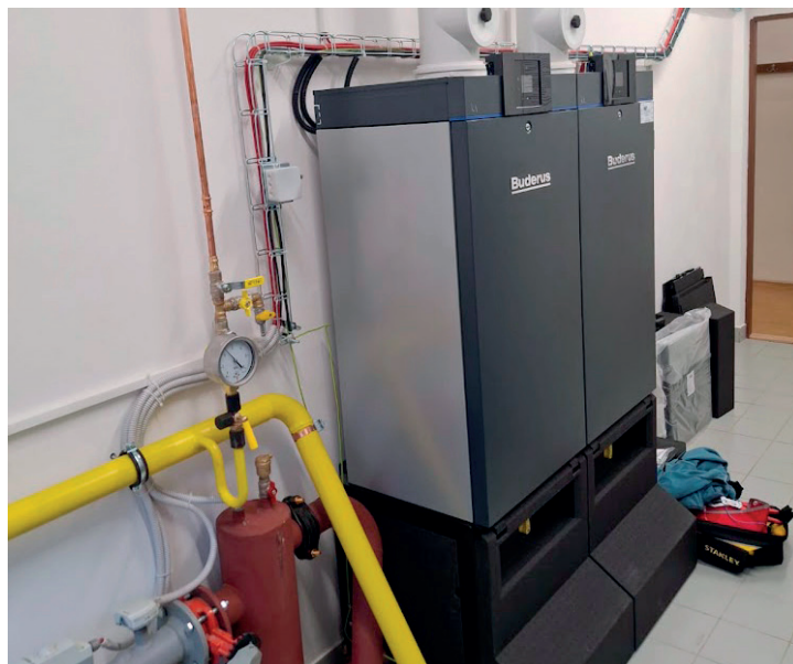
Kotelna v Mateřské škole Nad Parkem
