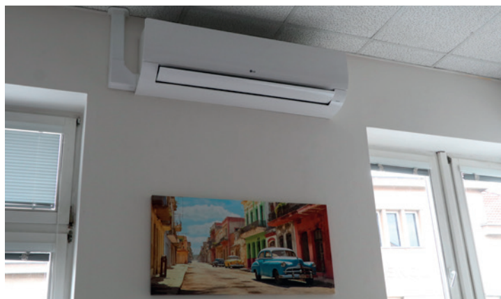
Nová klimatizace ve školní jídelně
